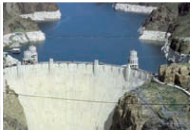
Lipiri structurale la baraje
